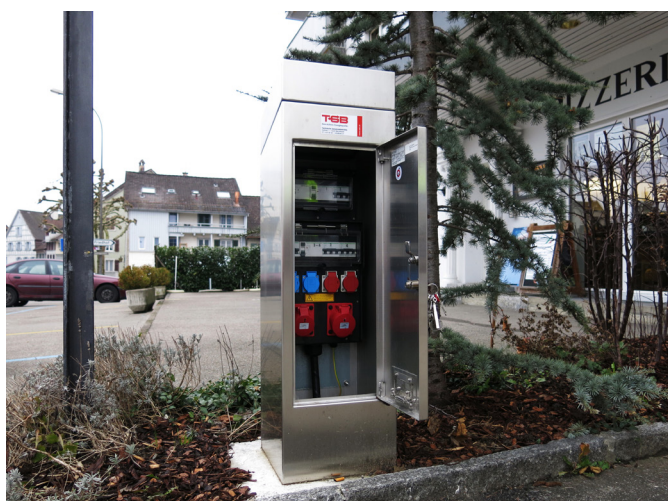
Colonnina d'energia elettrica QUADRO
