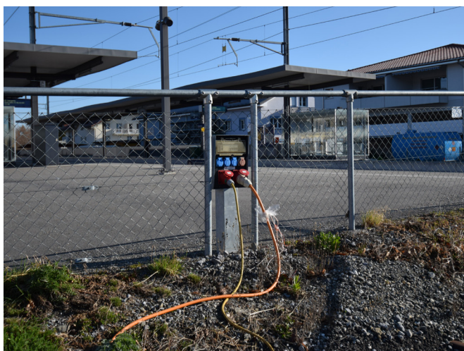
Quadro distribuzione presso la stazione Oberriet
